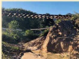
三陸鉄道 道床の流失
